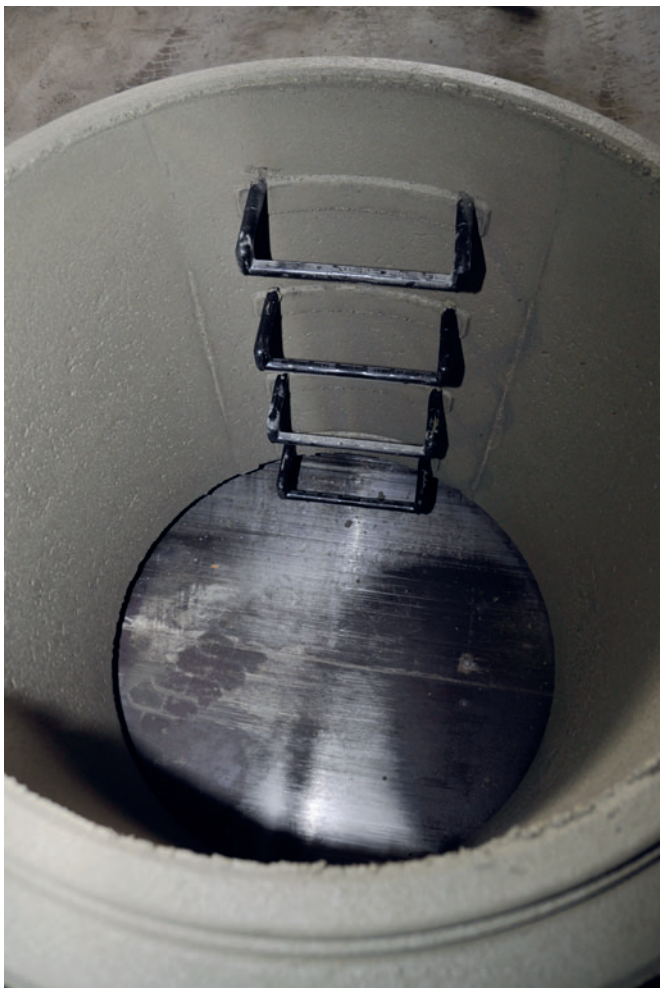
Schachtring mit Steigeisen
